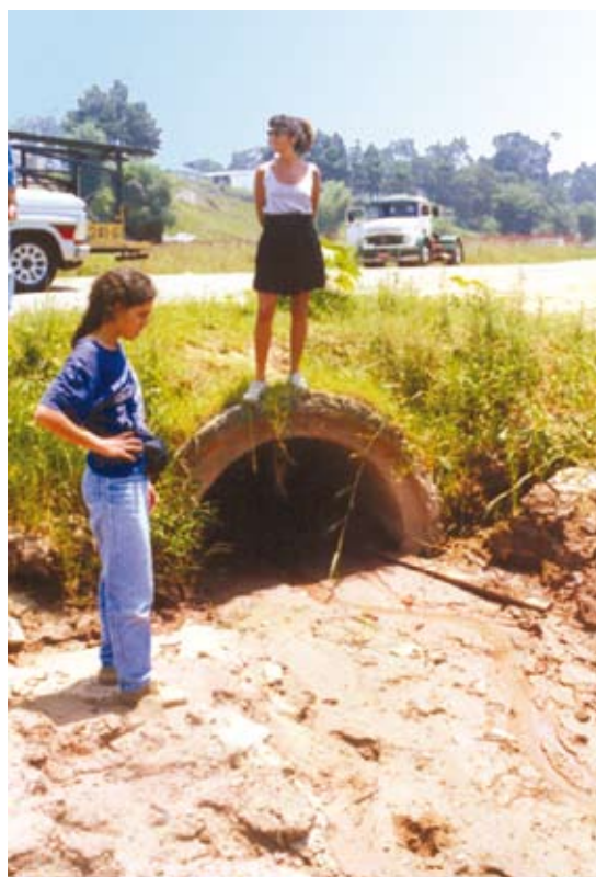
Figura 1.2.2.a – Foto de pontilhão obstruindo a drenagem.
