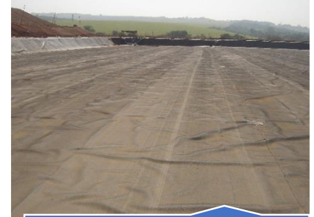
Manta de proteção instalada (Fonte: Cepollina, 2017)
