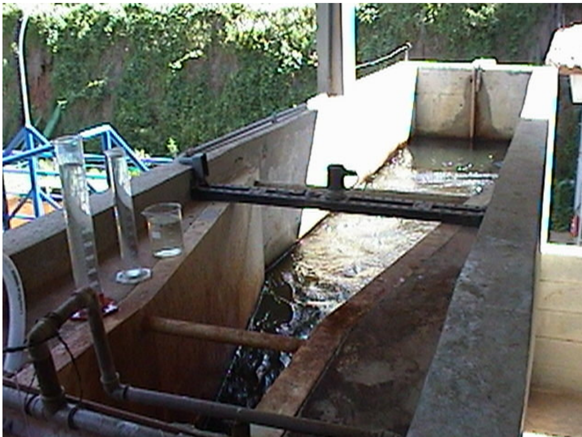
Figura 06 - Calha do tipo Parshall para medidas de vazão, instalada na entrada da Estação de Tratamento de Água – ETA do Cabuçu, do SAAE – Guarulhos.
