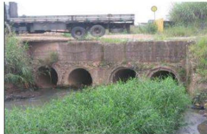
Foto 03 Vista para jusante do Rio Baquirivu, travessia da Rua Tamotsu Iwasse. EST. 949+00,0. OBS: Travessia sem proteção.
